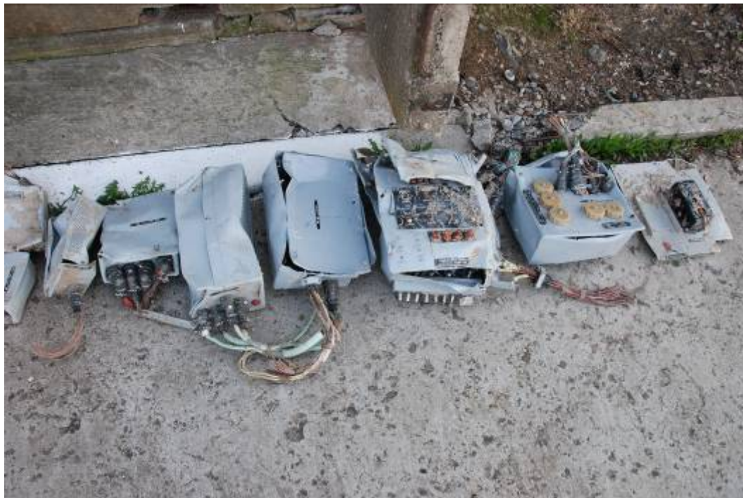
Rys. 30. Skrzynki sterowania instalacji elektrycznej
